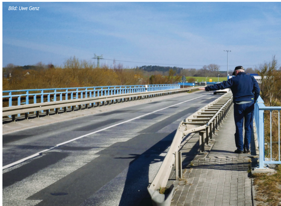
Gefahrstelle an der Brücke Mukran
